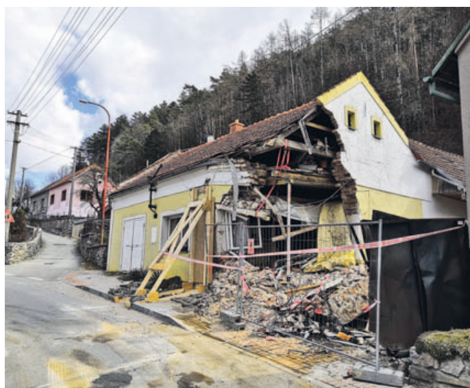
Dům poničený kamionem v blanenské místní části Lažánky. Foto: O. Požár
