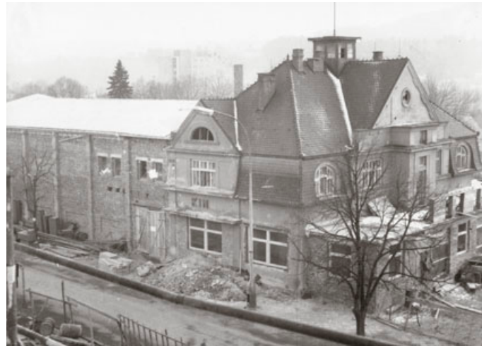
Současná podoba kina má základ v rekonstrukci z let 1967–68 . Provozní místnosti zůstaly, kinosál byl postaven nový, přizpůsoben projekci 70mm filmu na panoramatickém plátně o rozměru 15,2 x 8,6 metrů. Foto: archiv Muzea Blanenska
