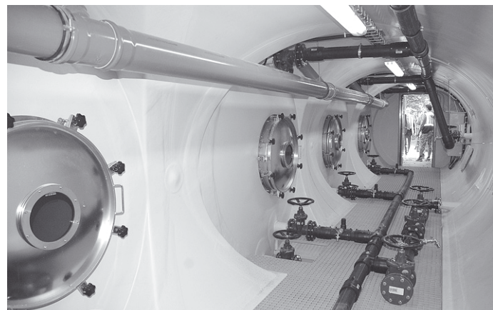
Trubkový vodojem o celkové kapacitě dvě stě kubiků vody vyřešil optimalizaci tlakových poměrů na Klepačově. Díky větší akumulaci vody si tak na nedostatek vody nemohou stěžovat ani místní hasiči. Foto: S. Mrázek
