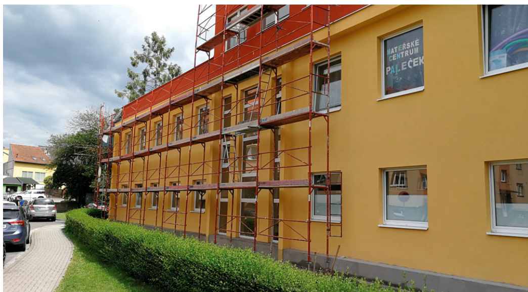
Rekonstrukcí aktuálně prochází i městská budova na K. J. Mašky. Novou fasádu jí město pořídilo za 1,3 milionu korun. Foto: J. Franchi
