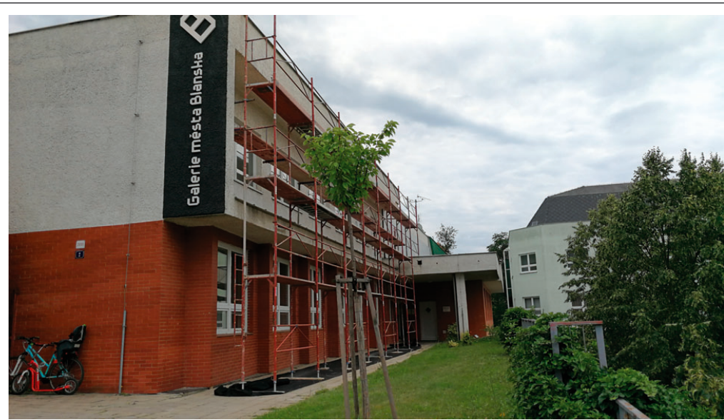
Podmáčenou opadávající omítku Blanenští opravují na budově Městského klubu důchodců. Foto: J. Franchi
