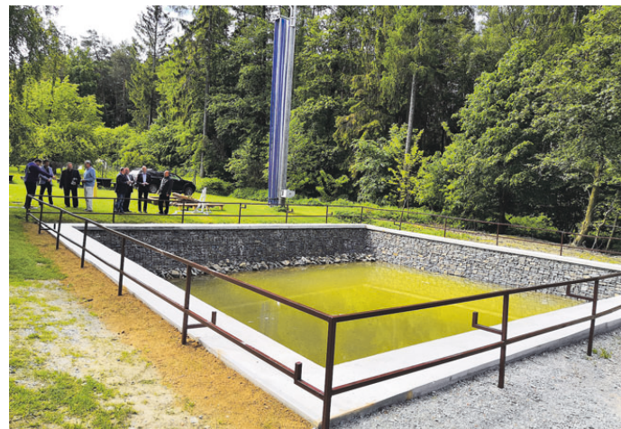
Opravu požární nádrže na Obůrce se podařilo dokončit o několik týdnů dřív oproti původnímu termínu. Foto: O. Požár
